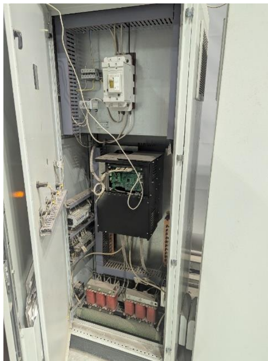
Рисунок 4.21 – Внешний вид шкафа автоматизации с преобразователем частоты
